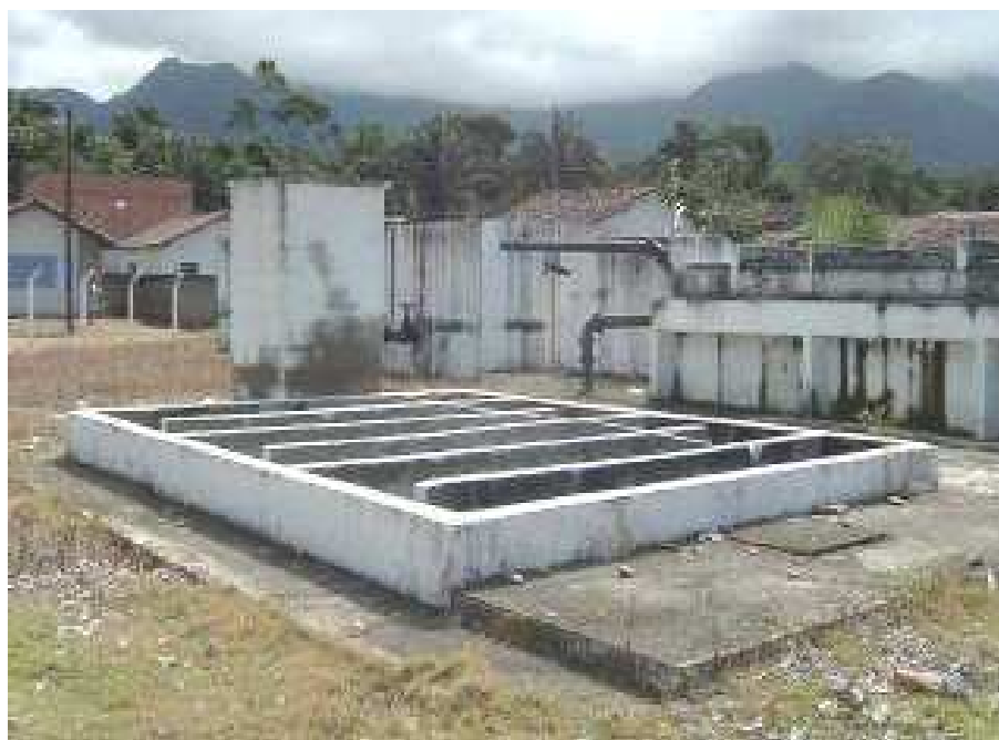
Foto 7 – Estação de Tratamento de Esgoto Taquaral. Fonte: SABESP.
