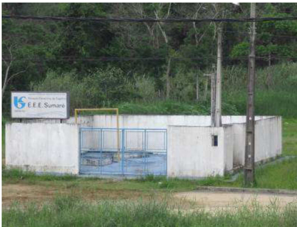
Foto 8 – EEE Sumaré – Sistema Principal
