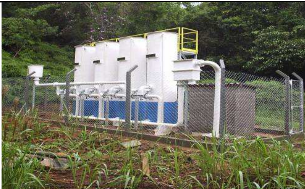
Foto 2 – Sistema de filtração – Itamambuca. Fonte: SABESP
